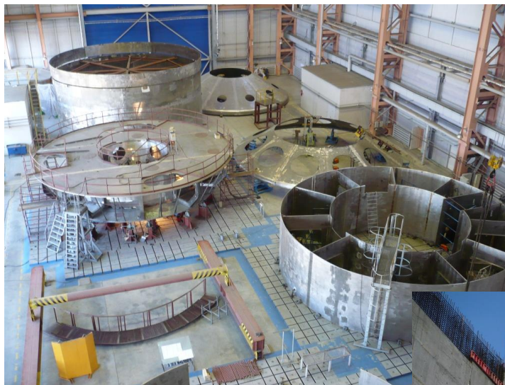
Корпус сборки реактора
